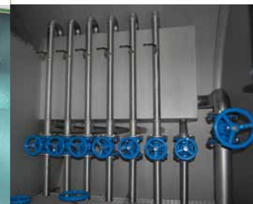
Spazio per gli allacciamenti di una cisterna per l'acqua potabile
