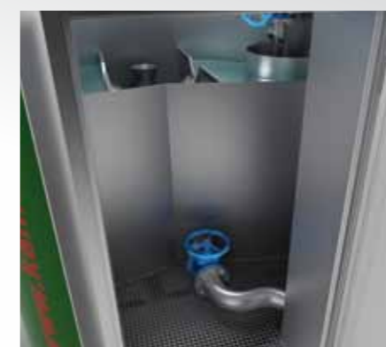
Pozzetto di accesso per pozzetti di raccolta dell'acqua di sorgente
