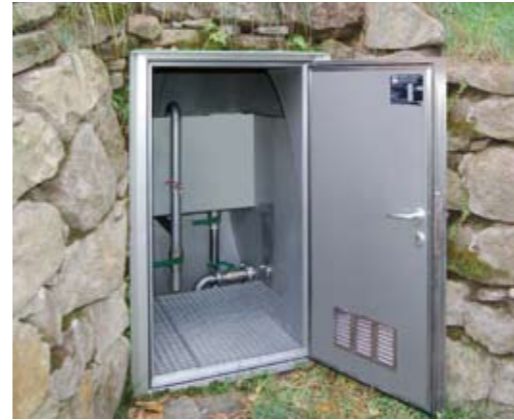
Eingangstür eines Trinkwasserspeichers
