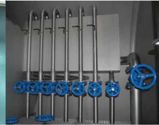
Abb. 4 - Armaturenraum eines Trinkwasserspeichers
